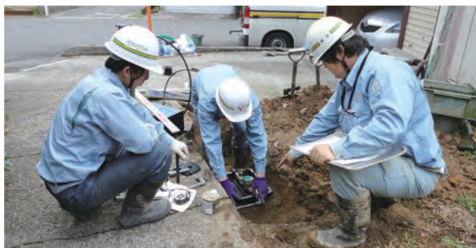
▲水道メーターの点検・管理
